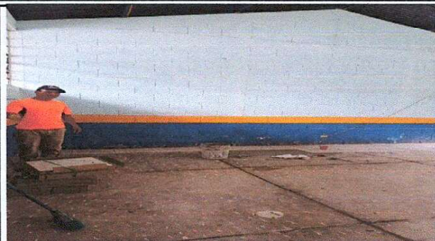
Foto1: piso en mal estado en modulo de aulas en proceso de instalacion.
